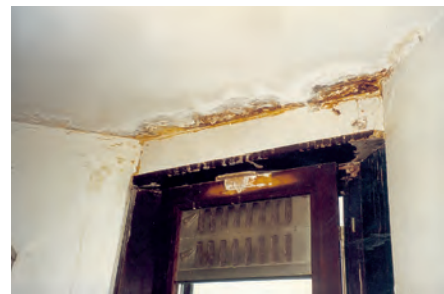
(4) Die Fassaden waren aufgrund konstruktiver Mängel undicht.
